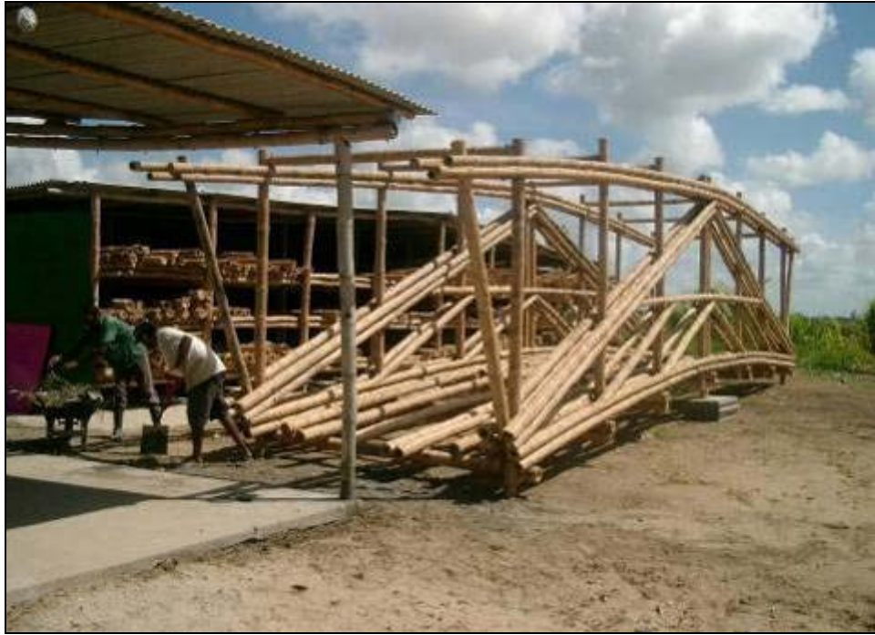
Foto 17: Puente de “cajón”, 12 metros, Guadua chacoensis en Maceio, Brasil. Sistema de Cerchas planas. Estilo medieval y muy usado en tiempos coloniales. El triangulo distribuye la carga hacia los estribos o hacia una tiranta que conforma el piso.
