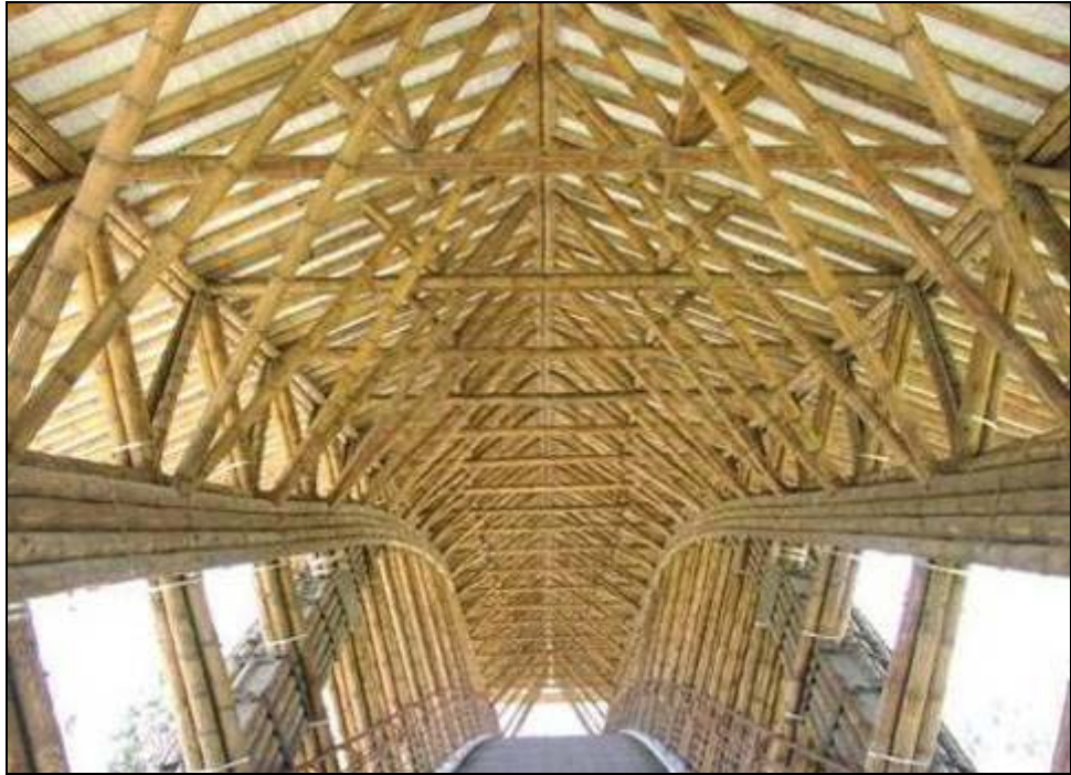
Foto 8: Puente “Jenny Garzón”, Bogota 2003, diseñado por Simon Vélez. El puente de 46 metros luz muestra los dos arcos con mucha claridad, la estabilización se ejerce mediante una estructura espacial, incorporado al techo amplio de 14 metros de anchura.
